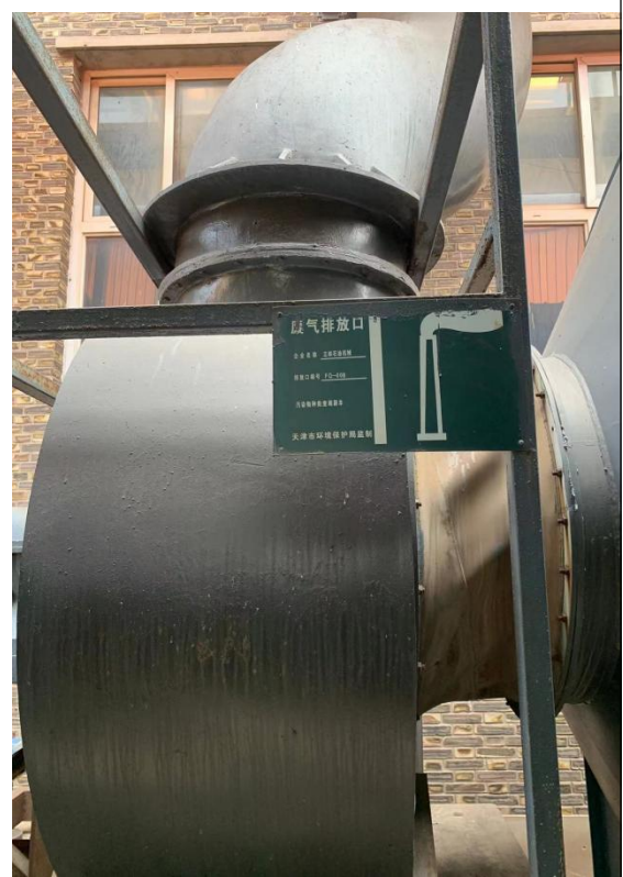
DA008 铬酸雾 8#排放口
