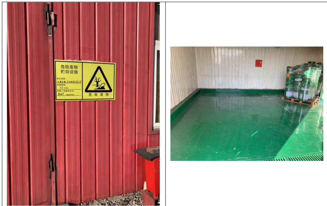
图 3.1-10 企业危险废物暂存间
