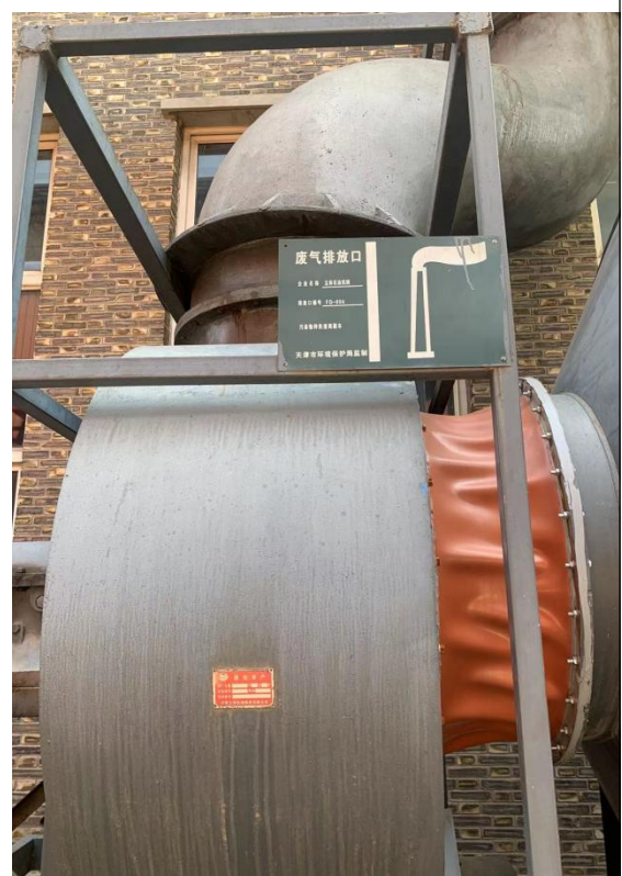
DA004 铬酸雾 4#排放口
