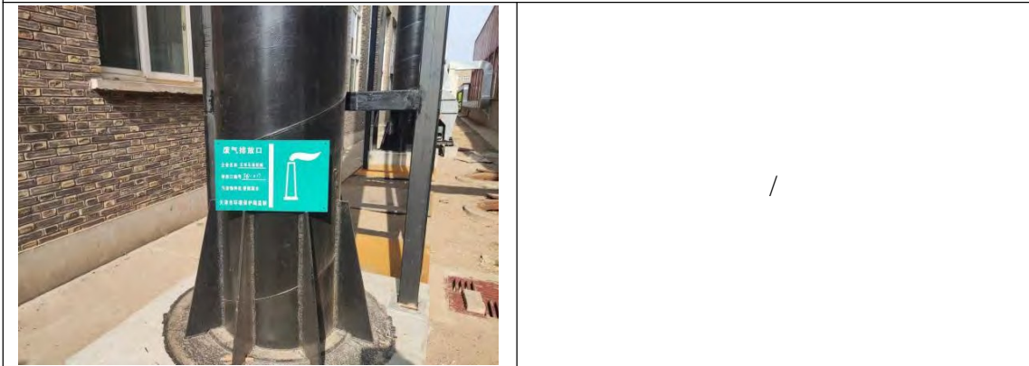
DA017 热处理排放口
