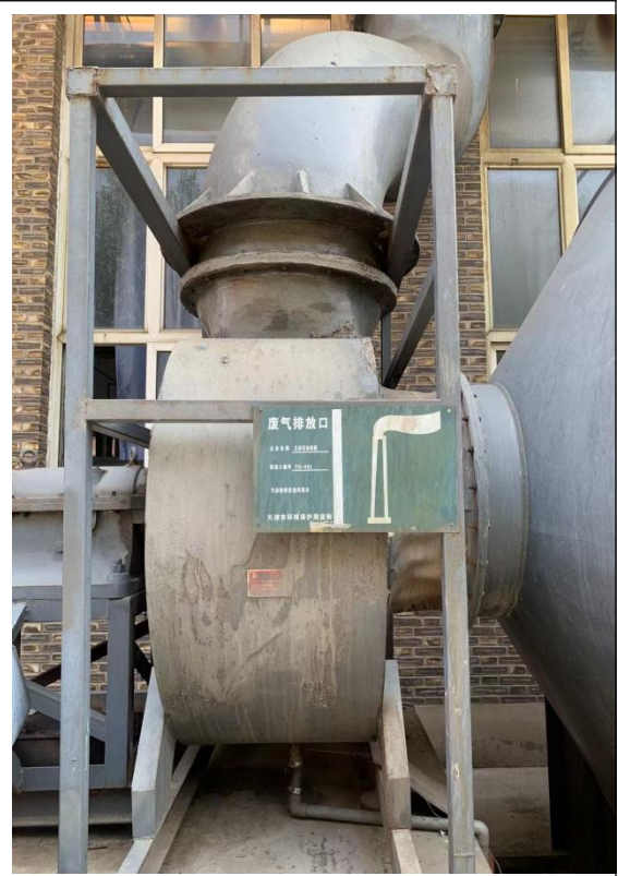
DA002 铬酸雾 2#排放口
