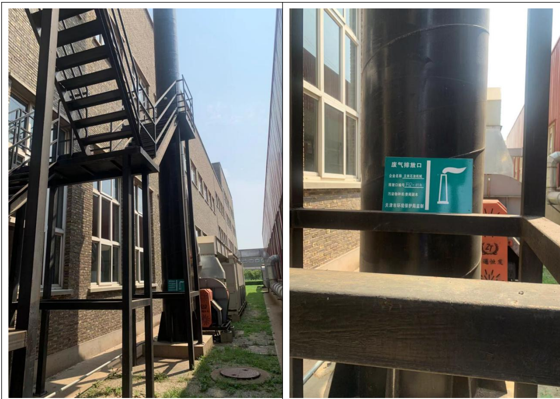
DA013 清洗排放口
