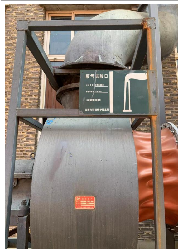
DA005 铬酸雾 5#排放口
