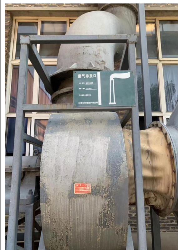
DA003 铬酸雾 3#排放口
