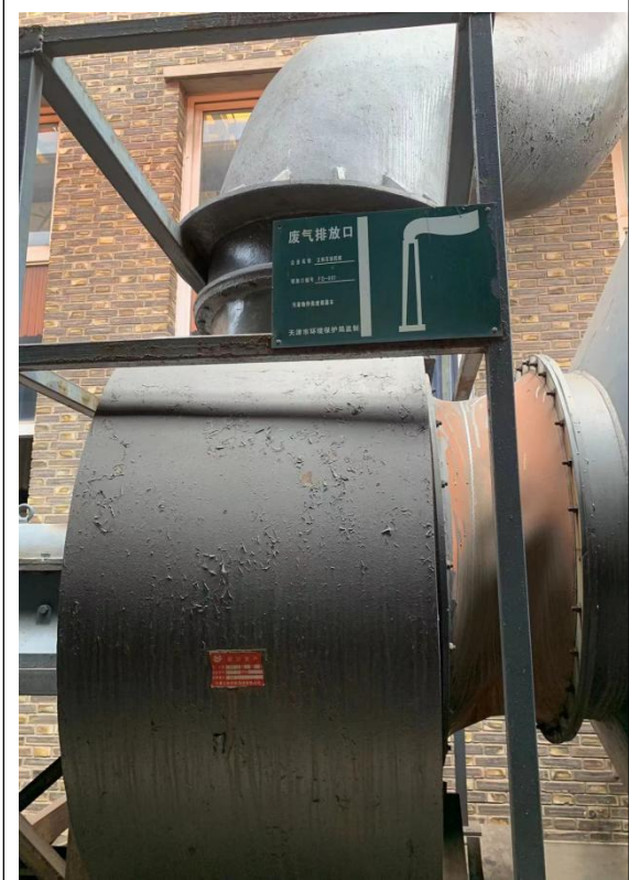
DA007 铬酸雾 7#排放口
