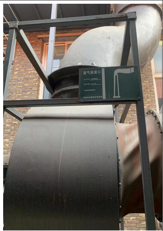
DA006 铬酸雾 6#排放口
